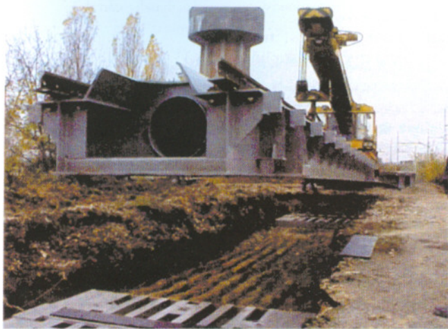
11. Posa dell'impalcato monolitico del ponte Bologna 17 durante il collaudo statico del prototipo presso un binario di scalo a Bologna.
