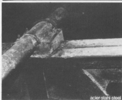
Fig. 7. Tubi di sostegno delle tende già disposte a regolare la luce immessa nei lucernari. Questi tubi hanno assicurato in modo non previsto il controventamento longitudinale delle incavallature.
